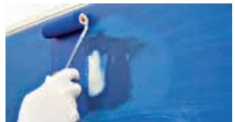
Flekk med primer
