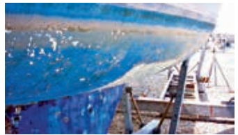
Blærer i og avskalling av maling
